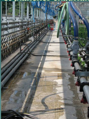
2 grosseurs de buses sur rampe et plancher chauffant
